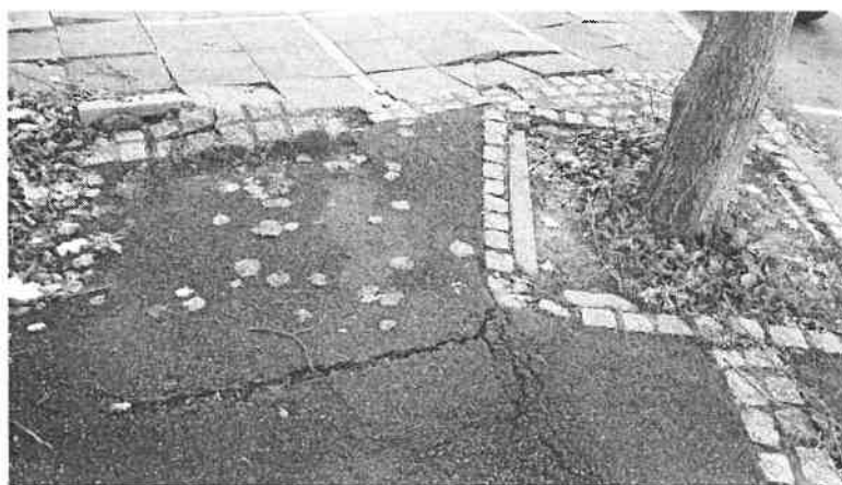
(ex : trottoir de la rue F. Garcia Lorca qui est impraticable)
